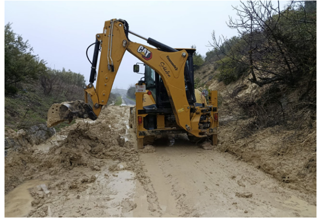
Corrimiento de taludes en la Vía Verde
