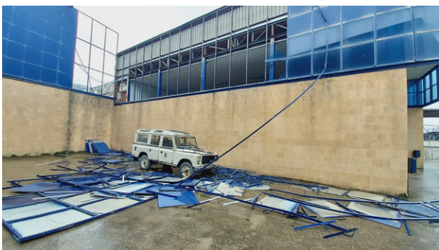
Caída del cerramiento de una nave municipal en las antiguas instalaciones de Crismona
