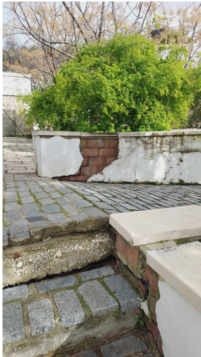
Graves deterioros en el Parque de la calle Mina
