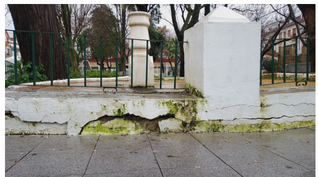
Hundimiento de la esquina del Parque Municipal
